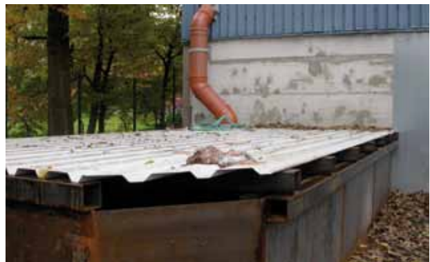
Fa. Spicer: der umfunktionierte Spänebehälter zur Regenwasserspeicherung
